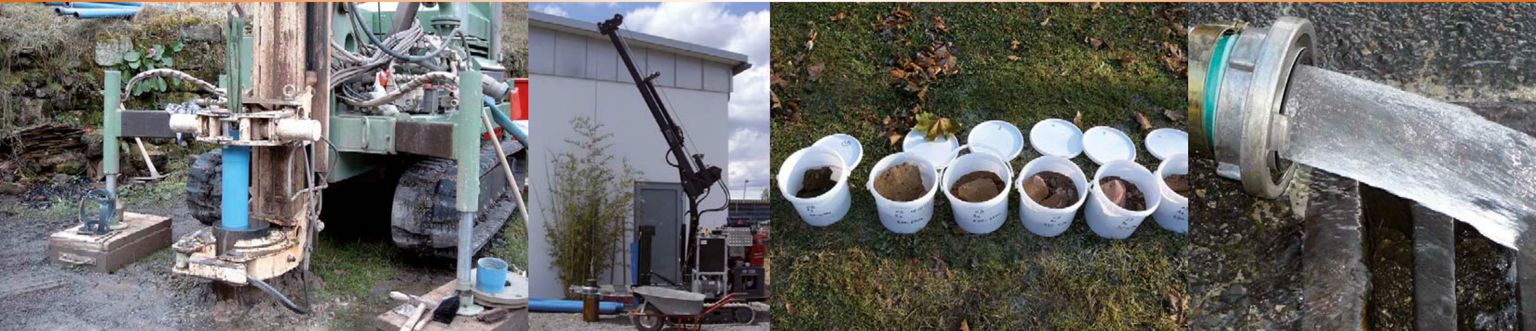
Bohrungen für Grundwasserwärmepumpen, links: im Festgestein (Bildquelle: Hydrogeologisches Büro Dr. Köhler, Eppingen), rechts: im Lockergestein (Bildquelle: Firma Krämer Bewässerung GmbH, Dettenheim-Rußheim).
