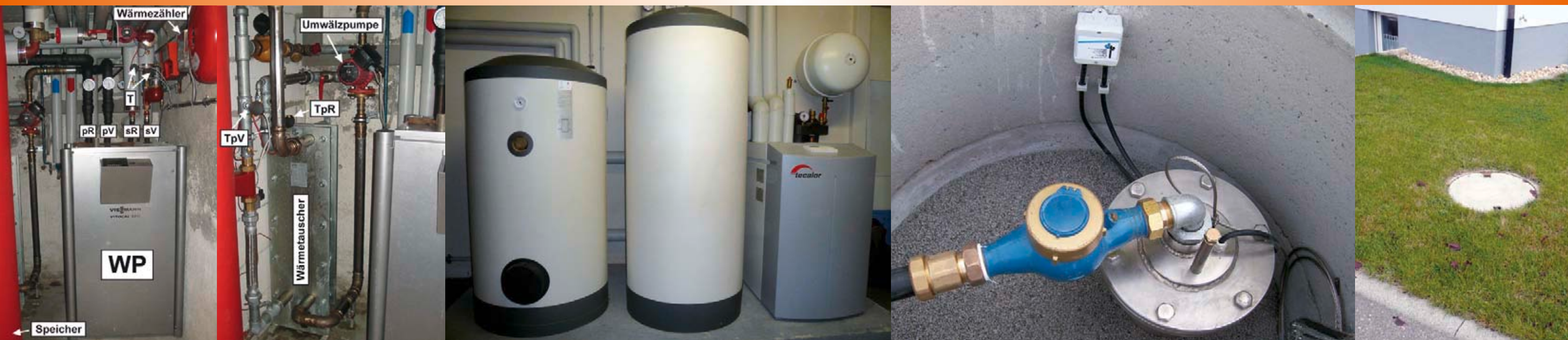
links: Überprüfung der Anlageneffizienz durch Messtechnik, Beispiel Wärmepumpenanlage „Pfarrgarten“ mit geschraubtem Trennwärmetauscher: Durchfluss-, Temperatur- und Wärmemengenerfassung im Primär- und Sekundärkreislauf (T = Temperaturfühler, pV = primär Vorlauf; pR = primär Rücklauf, sV = sekundär Vorlauf, sR = sekundär Rücklauf, WP = Wärmepumpe (Bildquelle: EBERHARD & Partner AG, CH-Aarau); rechts: Grundwasserwärmepumpe mit Speicher (Bildquelle: Ingenieurbüro Zoller, Forchheim/Kaiserstuhl)
