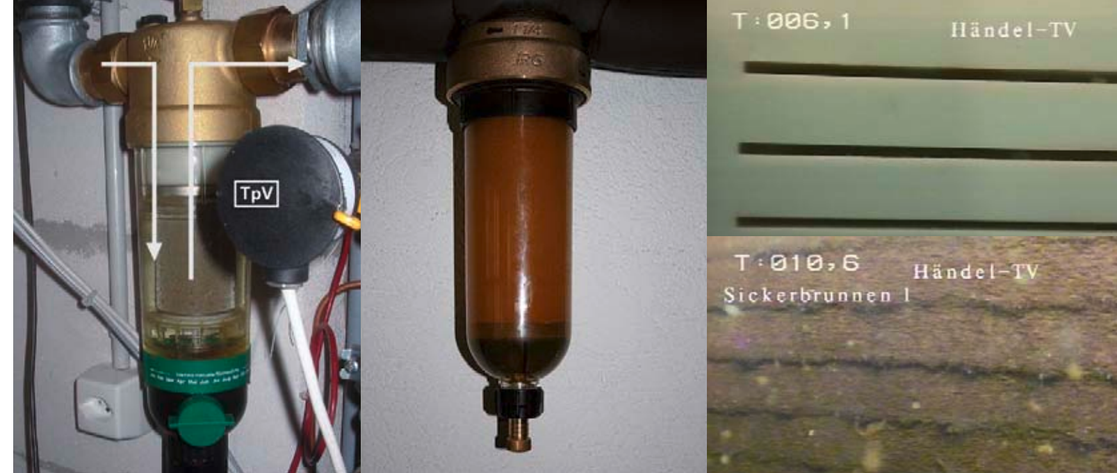
links: automatisch rückspülbarer Sandfilter im Vorlauf des Primärkreislaufs (TpV = Temperaturfühler primär Vorlauf); Mitte: Sandfilter, verstopft durch Eisenausfällungen (Eisengehalt des Grundwassers: 0,2 mg/l) Bildquelle: EBERHARD & Partner AG, CH-Aarau; rechts oben: sauberer Brunnenfilter, rechts unten: verockerter Brunnenfilter Bildquelle: W. Händel, Geophysikalische Bohrlochmessungen und Brunnen-TV, Ubstadt-Weiher
