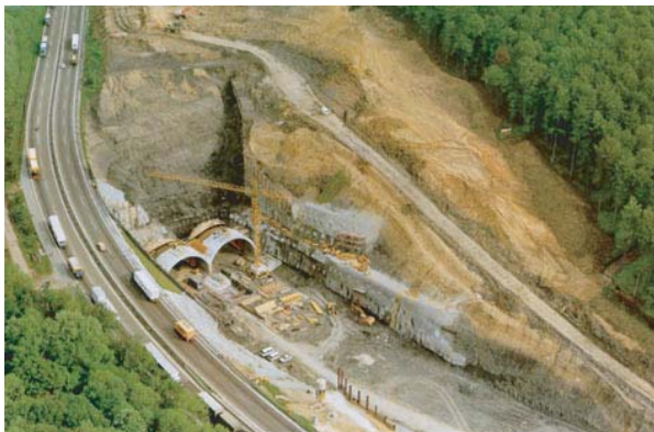
Eines von vielen Bauvorhaben im Land, bei deren Verwirklichung das Fachwissen des LGRB gefragt war: Der Alaufstieg der A8
