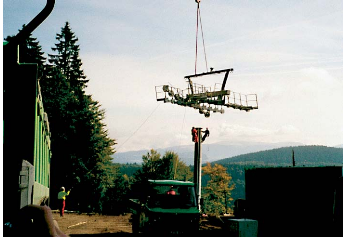
Ansetzen einer Rollenbatterie
