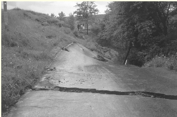
Abb. 3: Eine Rutschung am Eichberg zerstörte am 7. 1. 1966 die alte Landstraße von Achdorf nach Eschach (8117 Blumberg)
