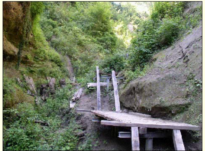
Abb. 2: Zerstörte Stege am Schluchtgrund
