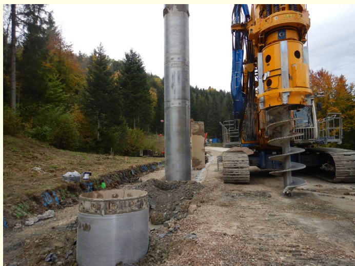
Abb. 3: Errichtung einer 20 m tiefen Entwässerung mittels überschnittener Kiespfahlwand entlang der L170 zwischen Bonndorf und Schattenmühle zur Sanierung eines aktiven Rutschhanges, Lkr. Waldshut
