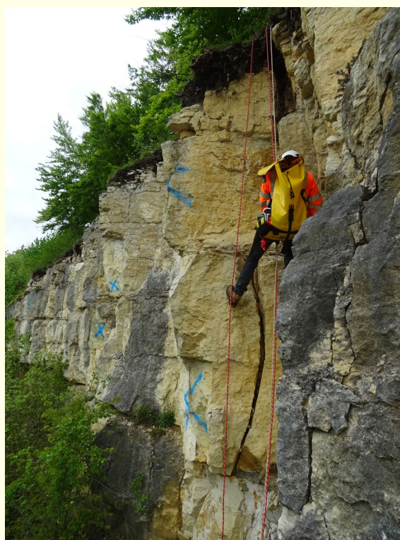
Abb. 2: Beurteilung potenziell absturzgefährdeter Felspartien durch Mitarbeiter des LGRB an einer ca. 20 m hohen Felswand entlang der L250 Hülbenener Steige, Lkr. Reutlingen
